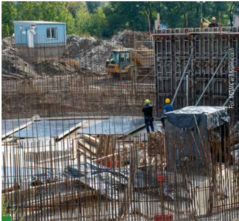
BUDOWA OSADNIKA WTRÓNEGO Widoczne zbrojenie oraz deskowanie ścian obwodowych przygotowane do betonowania
