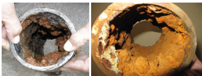
FOT. 3. | Przykłady inkrustacji rur przyłączy wodociągowych ze stali
