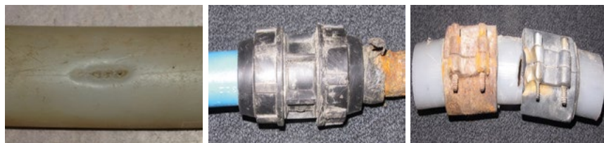
FOT. 2. | Przykłady awarii rur przyłączy wodociągowych z LDPE
