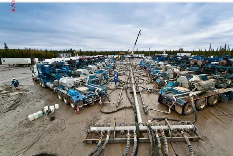
FOT. 1. | Stanowisko do eksploatacji złoża ropy naftowej metodą szczelinowania
