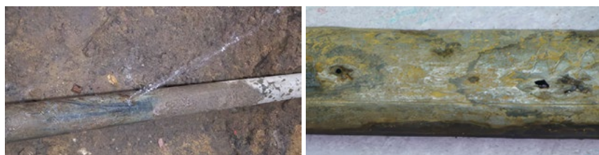
FOT. 1. | Przykłady awarii rur przyłączy wodociągowych ze stali
