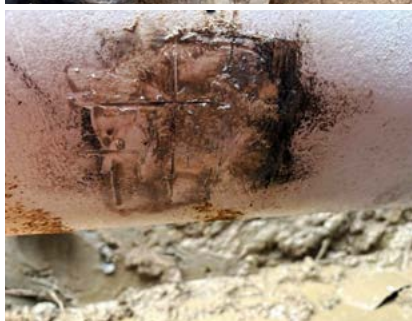
FOT. 5. | Powierzchnia zewnętrzna laminatu zdjętego z pierwszego uszkodzenia powłoki 3LPP
