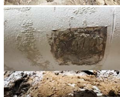
FOT. 1. | Uszkodzenie powierzchniowe warstwy laminatowej
